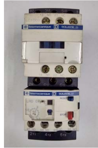
รูปที่ 4.2 ตรวจเช็คแมกเนติกคอนแทคเตอร์ใช้คลิปแอมป์เช็คการทำงานสามารถตัด-ต่อการทำงานของมอเตอร์ได้
