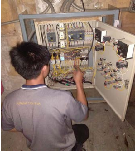
รูปที่ 4.1 ตรวจเช็คตู้คอนโทรลใช้คลิปแอมป์ การตรวจเช็คจุดที่อุปกรณ์เกิดการชำรุด
