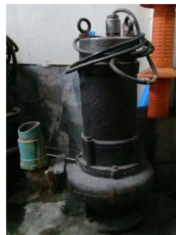
รูปที่ 4.6 ตรวจสอบเช็คมอเตอร์ปั้มน้ำ ใช้คลิปแอมป์เช็คขดลวดมอเตอร์
