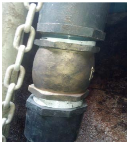
ท่อภายในบ่อบำบัดน้ำเสีย
