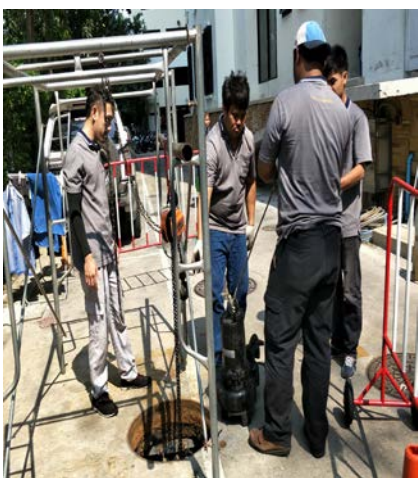
ตรวจเช็คมอเตอร์ปั้มน้ำ
