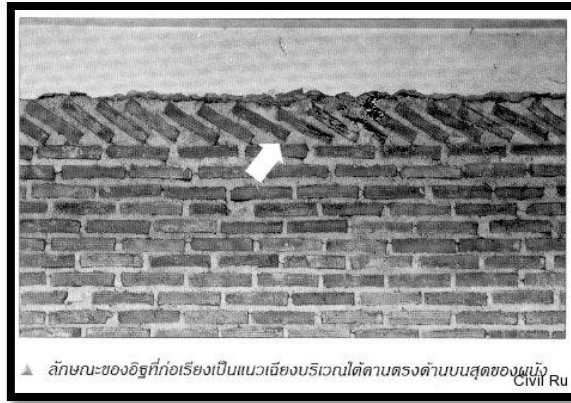
ข. อิฐสามัญญ์(อิฐมอญ)ก่อครึ่งก้อนบริเวณใต้คานเพื่อให้ผนังชิดคาน
