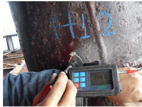
รูปที่ 4 ตรวจสอบกำลังรับแรงดึงของเหล็กเสริม F_y ด้วย Hardness Test
