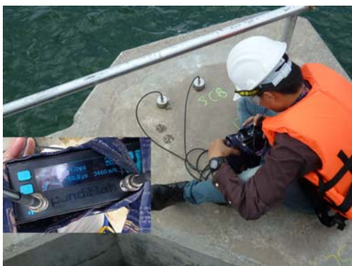
รูปที่ 3 ผลการตรวจสอบด้วย Ultrasonic Pulse Velocity
