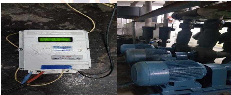
รูปที่ 4.3 การวัดพลังงานของปั้มน้ำเย็น
